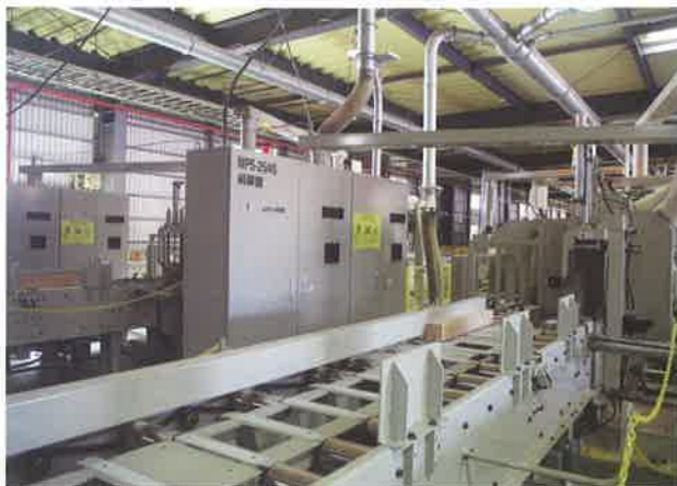
スリット加工機と木口加工機のセットは3機
